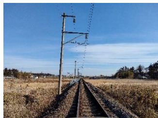
コンクリート柱の傾斜
